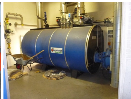
Billede 7: Naturgas kedelanlæg til spids og reservelast. (Foto: M. Støckler).
